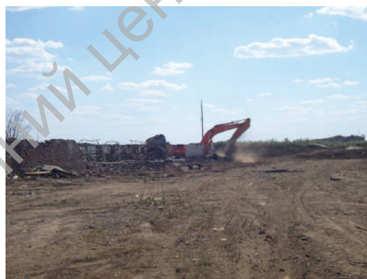
Рис. 29. Знищення залишків свинарського приміщення
